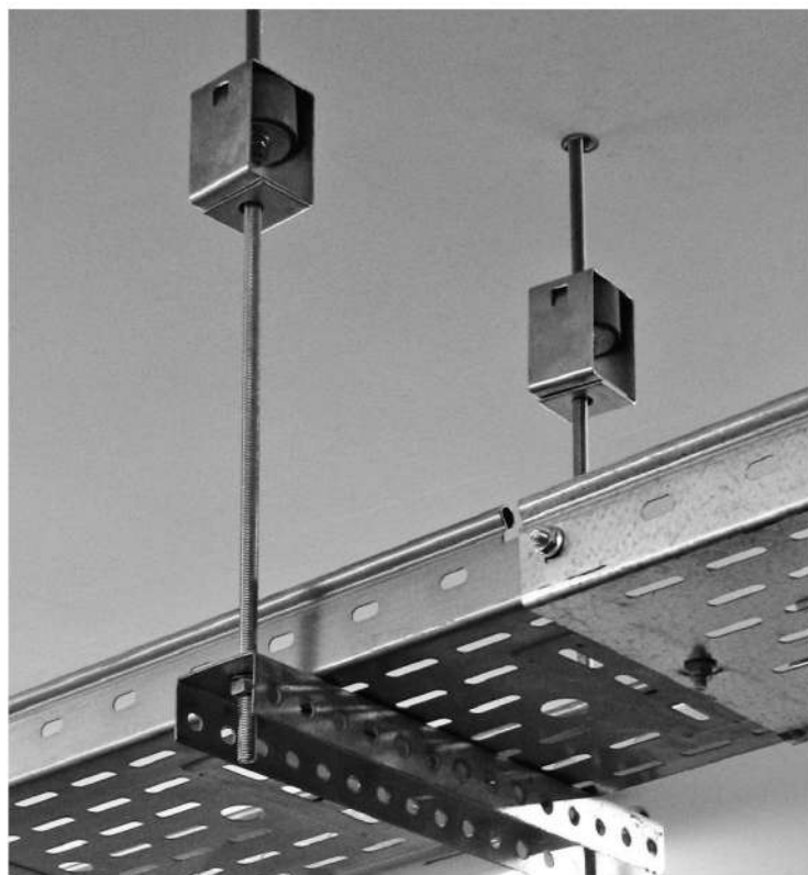
Виброизоляция лотков кабельных сетей
