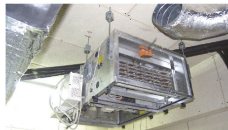
Виброизоляция подвешенной фанкойла Виброизоляторы: Vibrofix Box Объект: телекомпания "Новый канал", Киев
